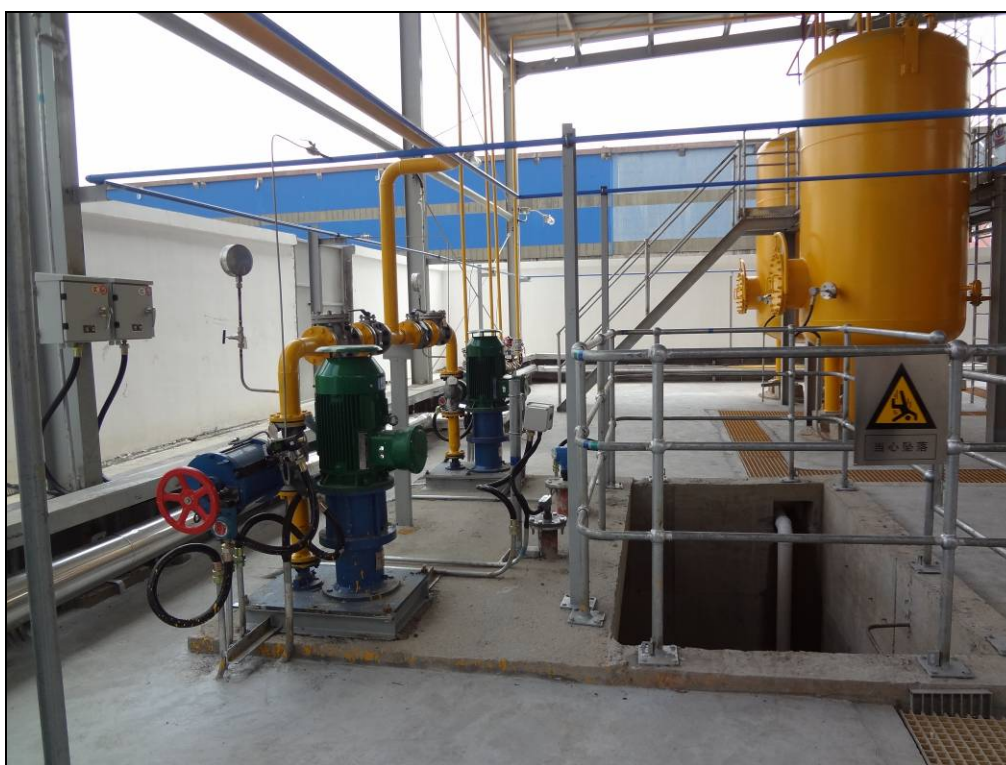
附图 8 液氮供应系统区污水泵
